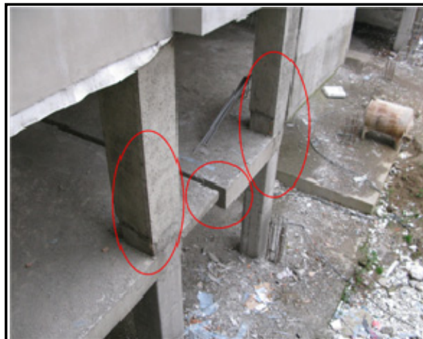
آسیب اجرا - اختلال در عملکرد یکپارچه سازه
