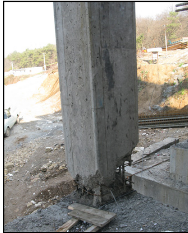
خوردگی و بتن ریزی ناقص پای ستون ها
