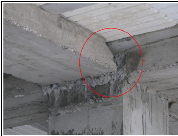
فرو رفتن بیش از اندازه تیر و ممانعت از بتن ریزی کامل
