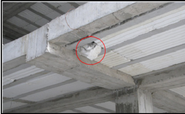
آسیب اجرا، فروکردن یونالیت اضافی بعنوان پرکننده
