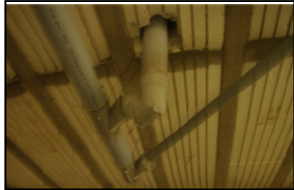
در نظرنگرفتن مکانی برای تاسیسات سوراخ کردن یونالیت های سقف و اتصال با سیم های فلزی عبور آن
