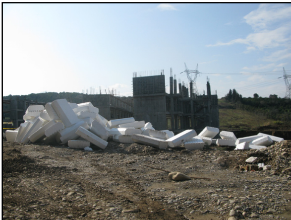
آشفتگی مصالح در محیط کارگاه
