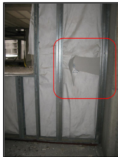
آسیب اجرا - پاره شدن لایه عایق کناف
