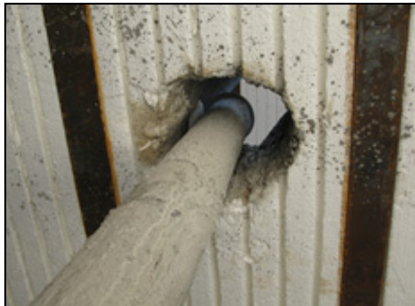
آسیب ناشی از عدم پیش بینی مکان تاسیسات
