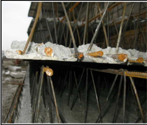
نقص بتن‌ریزی در تیرچه‌ها
