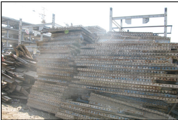
دپوی مصالح فلزی در محیط مرطوب کارگاه
