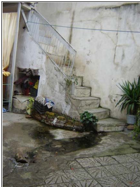
نمای داخلی یکی از خانه‌های کبوتردره؛ کف حیاط و جداره پله‌ها به دلیل بالا آمدن سطح آب چاه نم کشیده و تخریب شده است.
